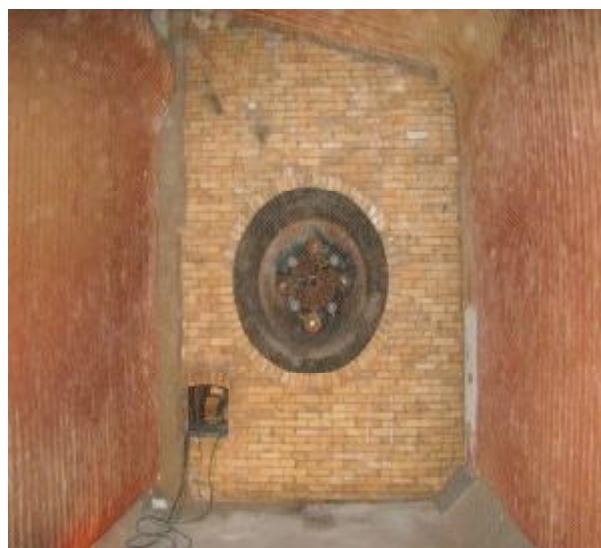
FOTO 09 – Vista frontal do queimador e da parede.
