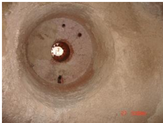
VISTA FRONTAL DO CARRETEL DO INCINERADOR
