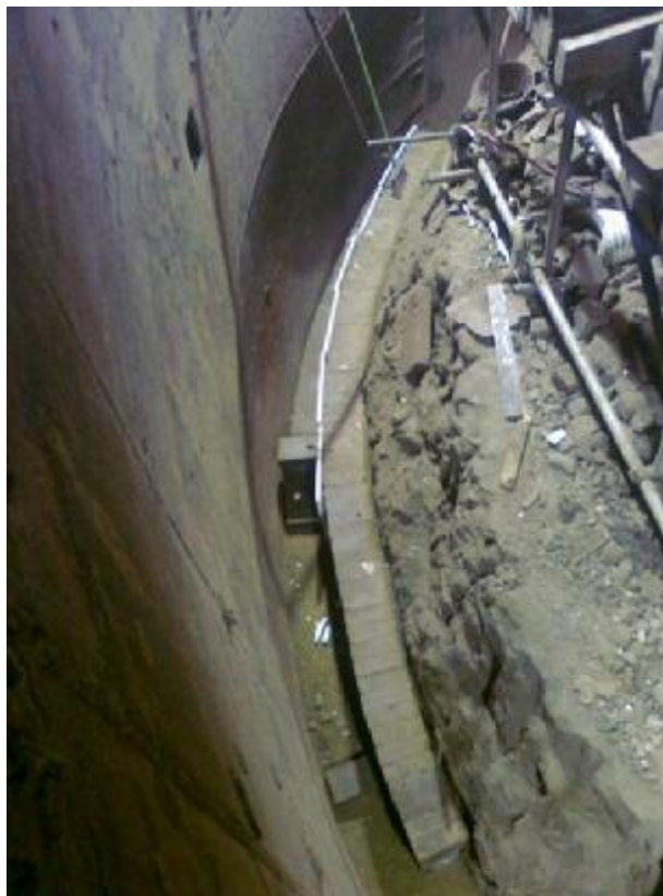
FOTO 06: Colocação de placas de isopor de 20 mm (juntas) após o tijolo de encosto.
