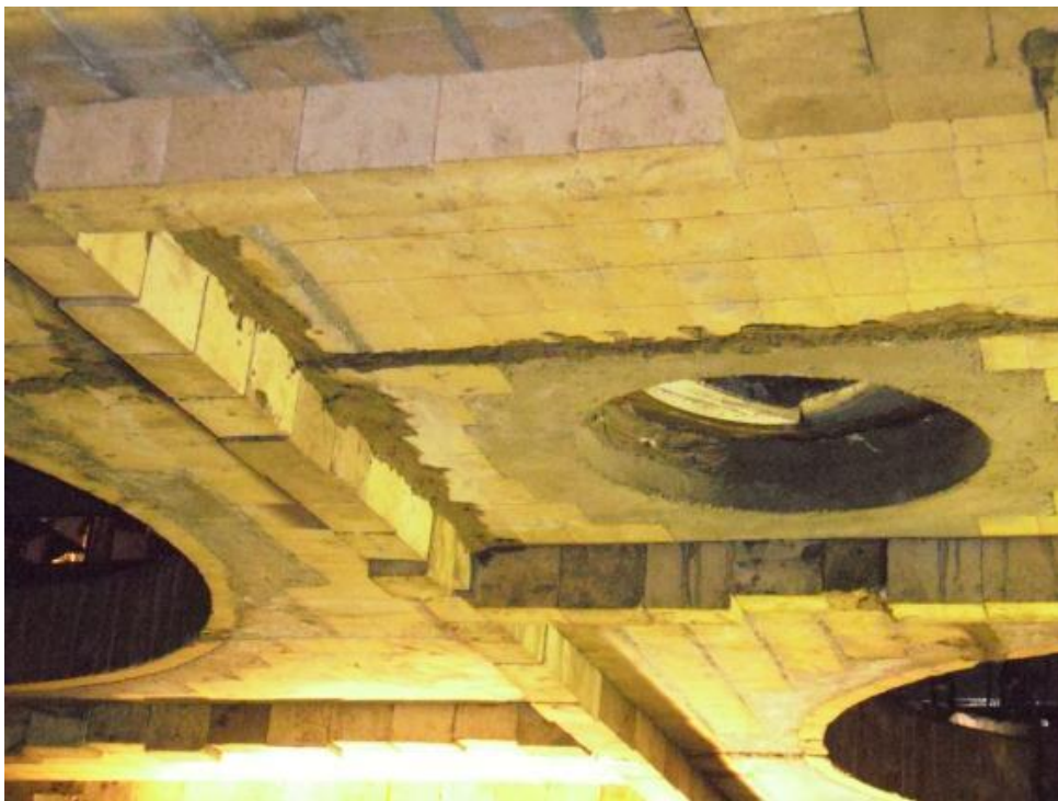
FOTO 29: Funis e refratário entre os elementos refrigerados
