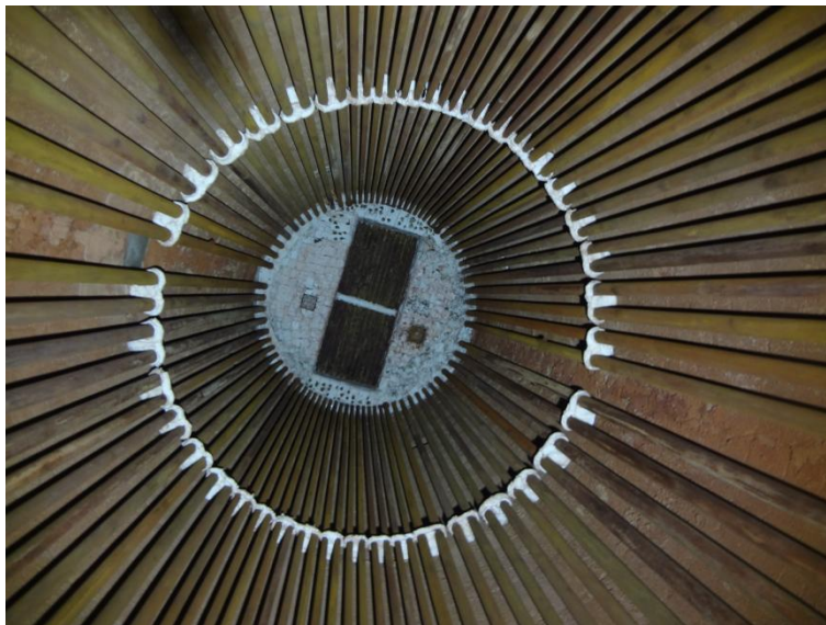
Imagem 19 - Vista do isolamento dos suportes das serpentinas da parede do teto e instalação da manta para complemento de espessura no teto.
