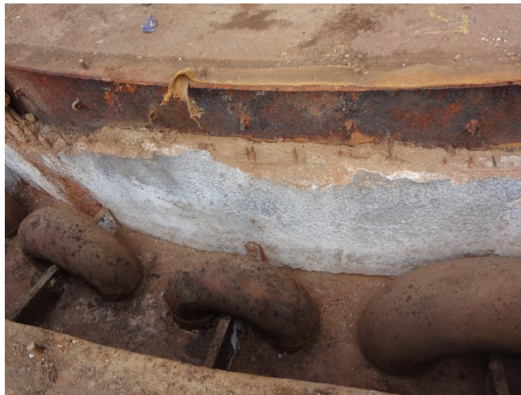
Imagem 25 - Detalhe da caixa de curva antes da recuperação.
