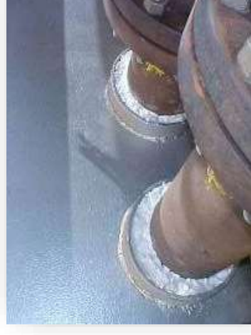
Vedação de entrada de "ar falso".
