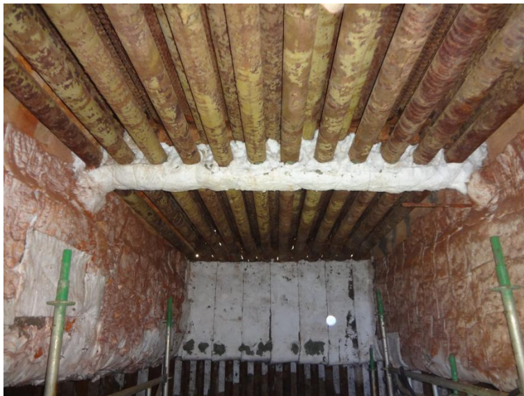
Imagem 18 - Detalhe da instalação do isolamento do suporte da serpentina do teto com manta de fibra cerâmica.
