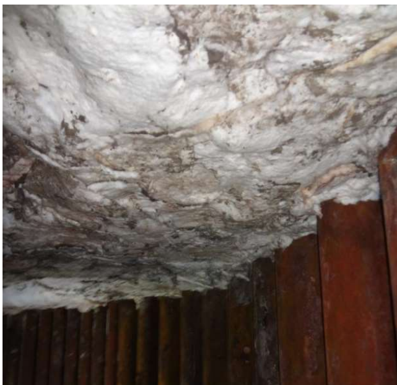
Imagem 12 - Detalhe da instalação de manta de fibra cerâmica no teto para complemento de espessura.
