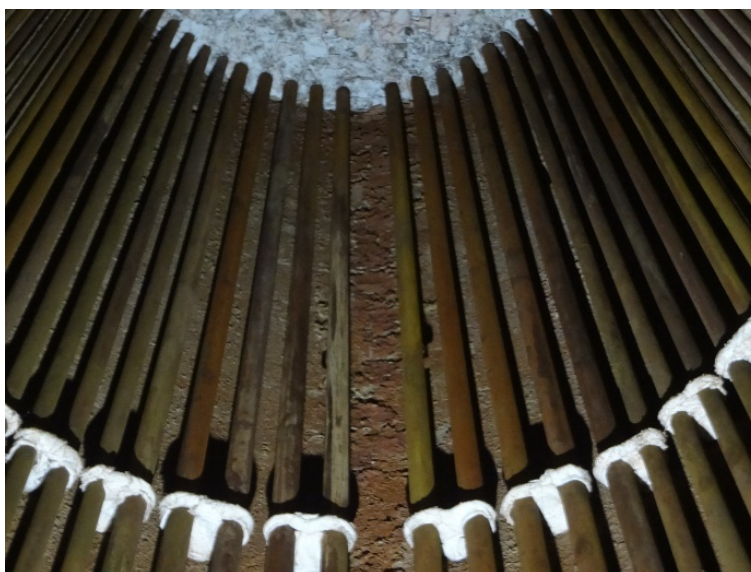
Imagem 7 - Suporte das serpentinas com isolamento de manta de fibra cerâmica.
