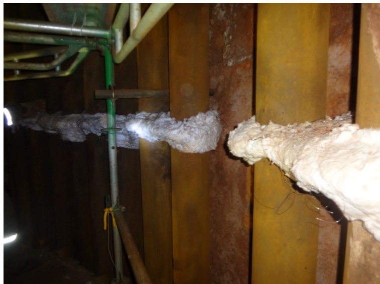
Imagem 6 - Suporte das serpentinas com isolamento de manta de fibra cerâmica e fixação com arame inox.
