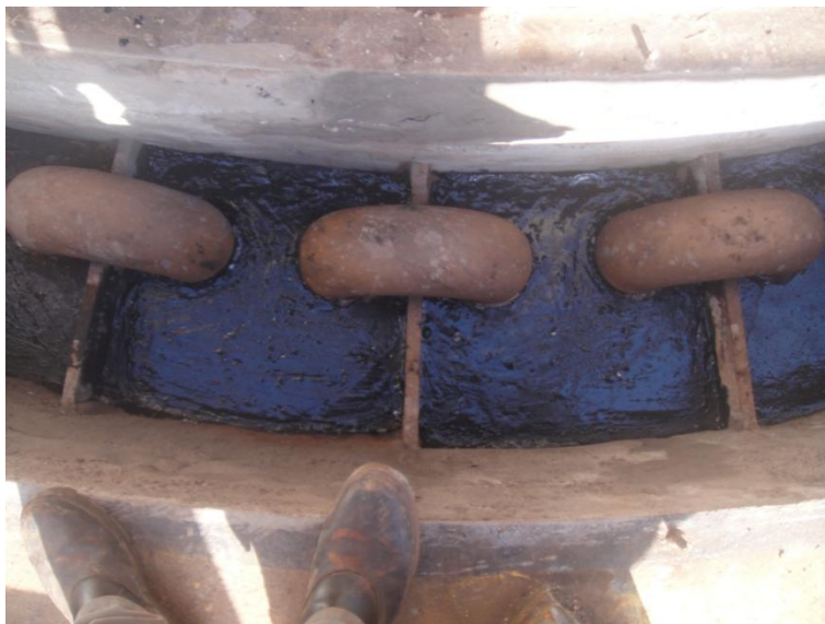
Imagem 28 - Detalhe da aplicação da massa anticorrosiva como parte da recuperação do revestimento.
