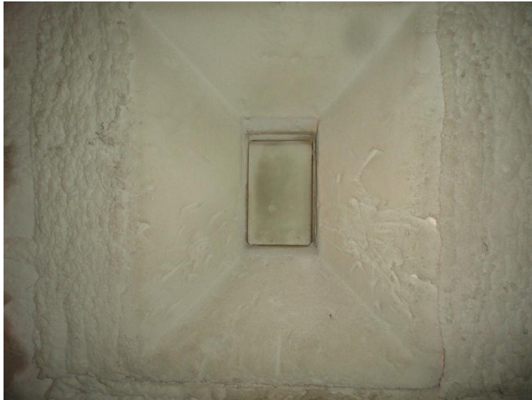
Imagem 25 - Vista interna do visor de inspeção com o tijolo refratário instalado.
