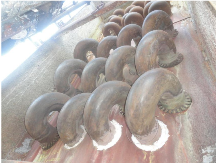
Imagem 17 - Vedação das caixas de curva da convecção.
