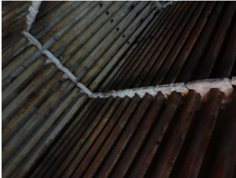
Imagem 9 - Isolamento dos suportes das serpentinas da radiação.
