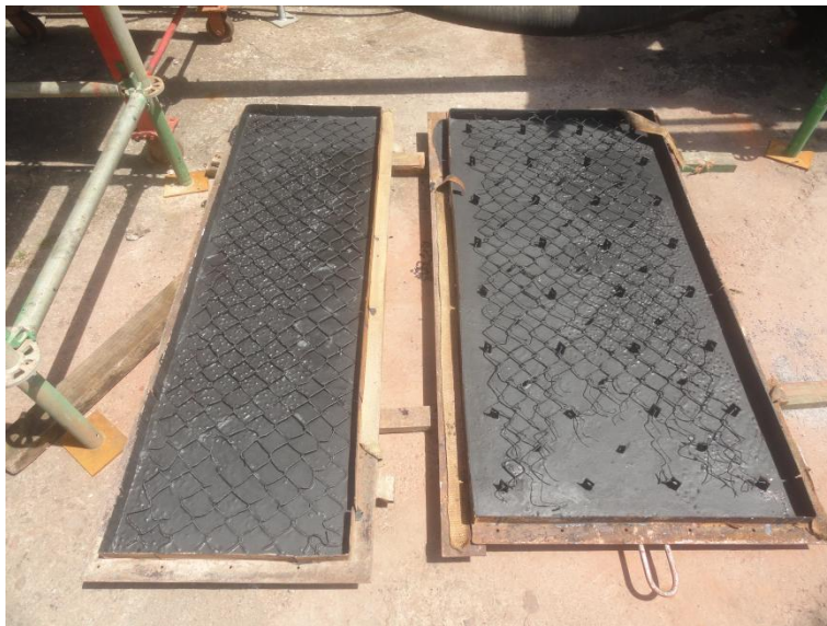
Imagem 5 - Aplicação de massa anticorrosiva nas portas das caixas de curva da radiação.
