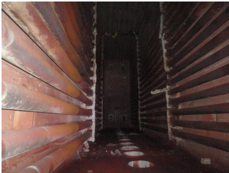
Imagem 10 - Isolamento dos suportes das serpentinas da radiação.
