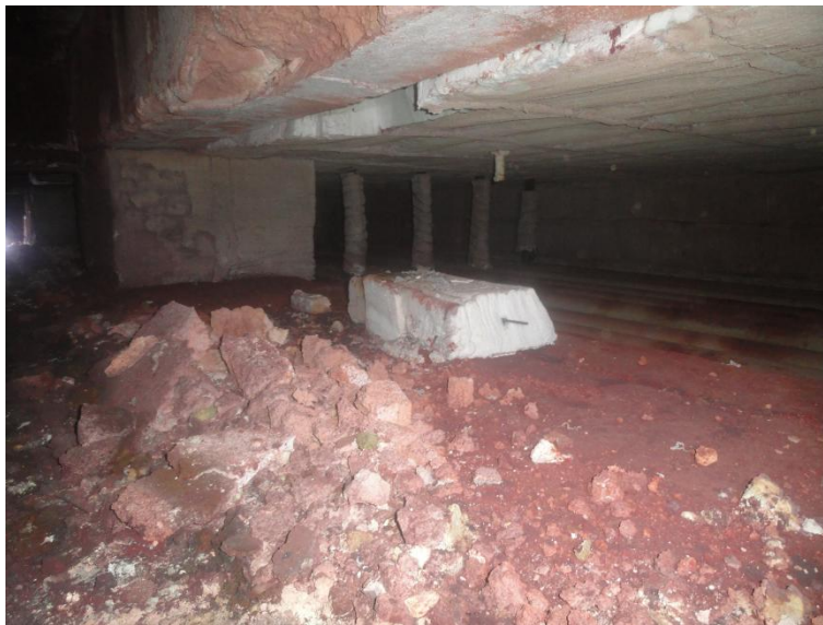
Imagem 12 - Módulos de fibra cerâmica ainda danificados no teto da transição.
