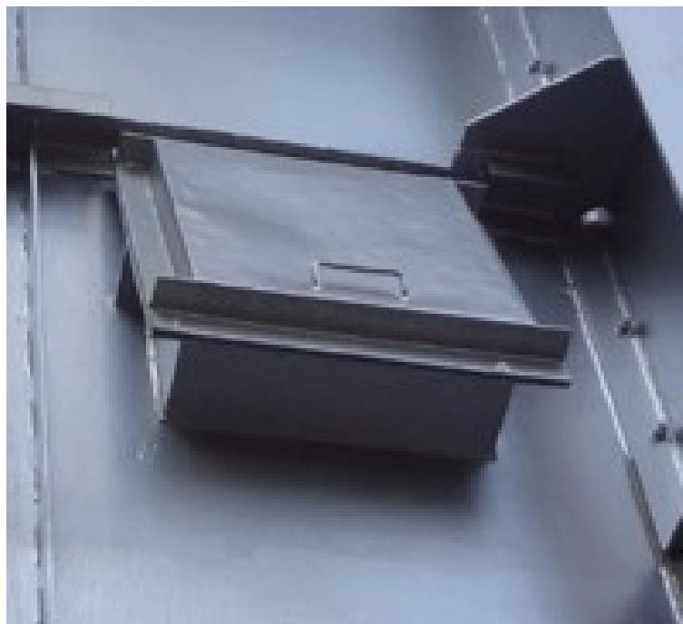
Imagem 27 - Janela de explosão após recomposição com embrechamento de fibra cerâmica.
