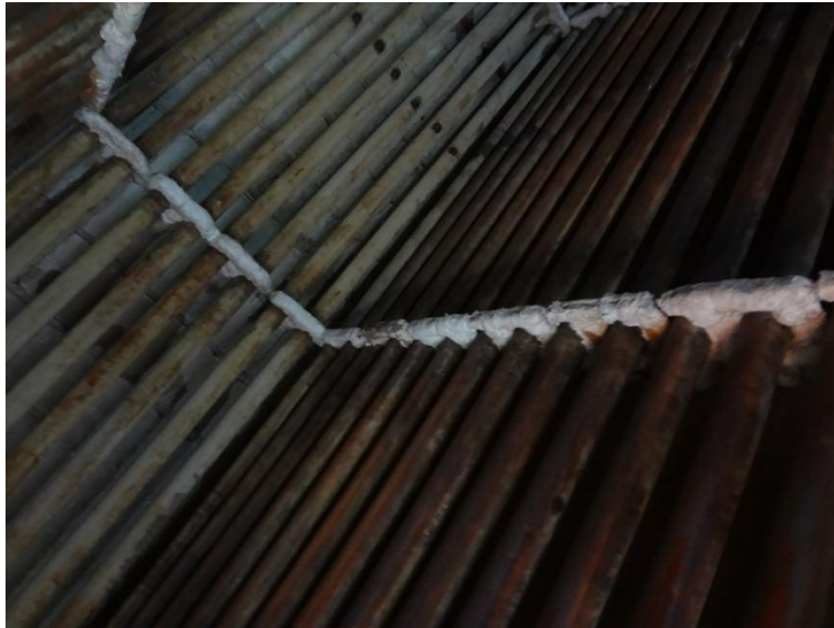
Imagem 3 - Isolamento dos suportes das serpentinas da radiação.
