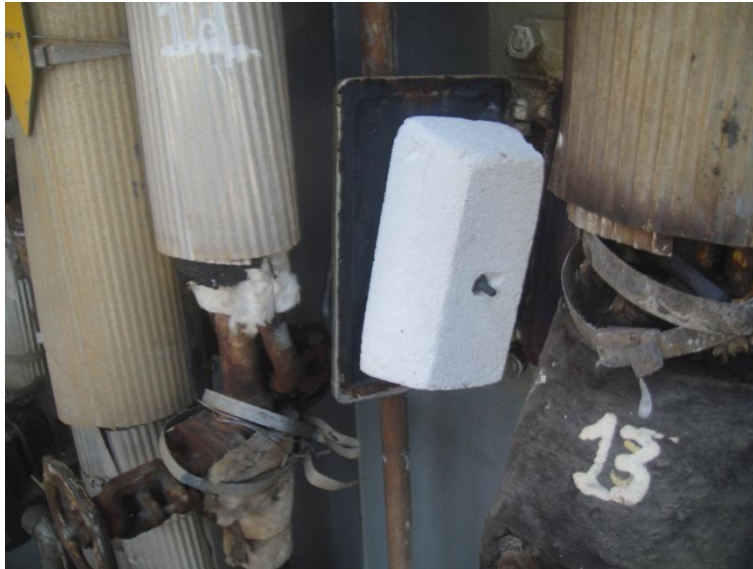
Imagem 24 - Janelas de inspeção com tijolo refratário.
