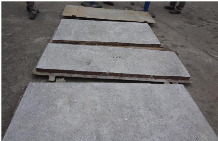
Imagem 10 - Recomposição do concreto refratário da tampa da caixa de curva.
