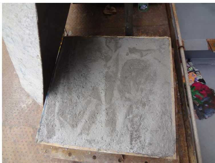
Imagem 17 - Concreto refratário da tampa das caixas de explosão.
