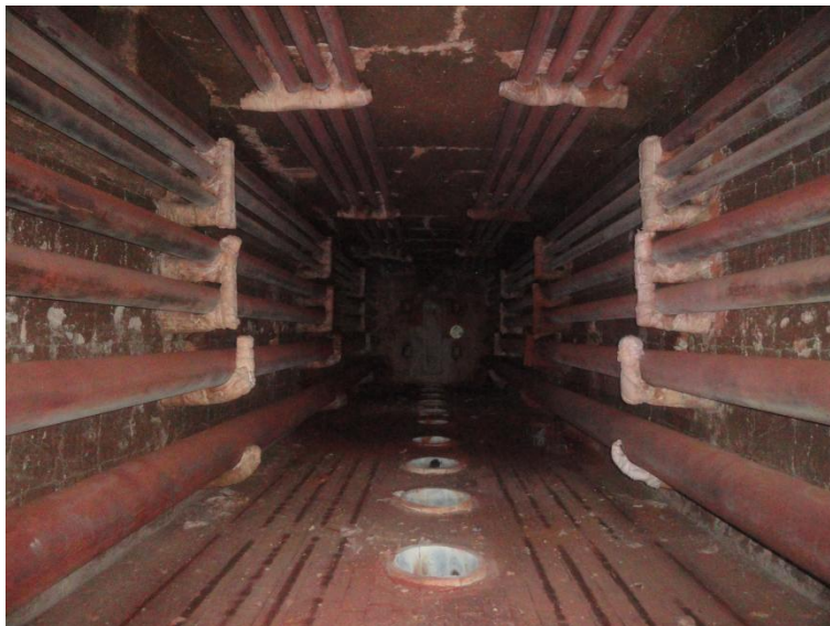
Imagem 4 - Isolamento dos suportes das serpentinas da radiação.
