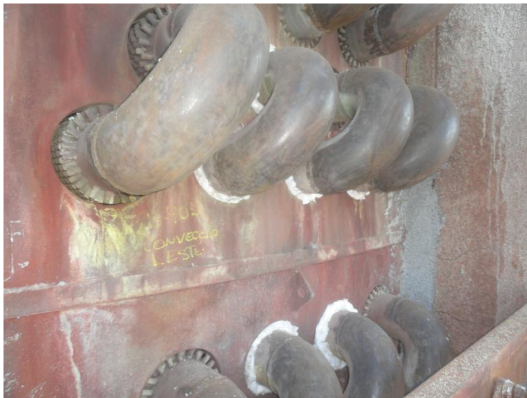
Imagem 11 - Vedação dos tubos das caixas de curva da convecção com fibra cerâmica.
