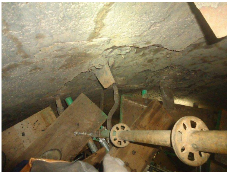
Imagem 3 - Detalhe do costado na parte inferior com o revestimento refratário prejudicado devido ao coqueamento.
