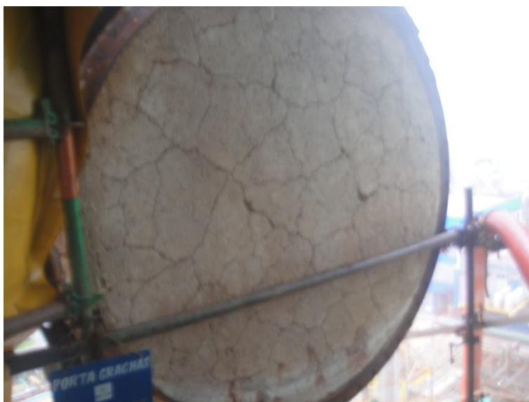
Imagem 18 - Refratário da tampa da BV de 54" do conversor danificado antes da demolição e restauração com concreto isolante PLW-41.
