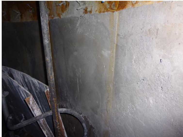
Imagem 12 - Remoção das fôrmas após o endurecimento do concreto agulhado para prosseguir com a cura e a montagem no nível subsequente.
