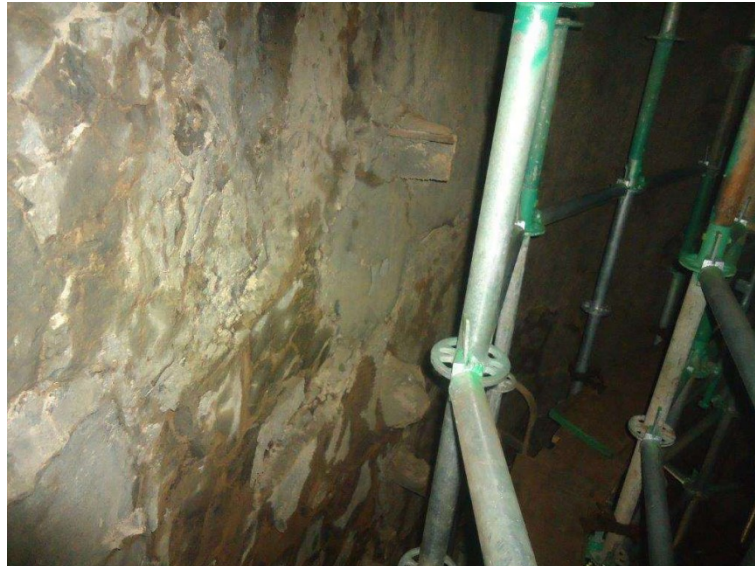
Imagem 2 - Detalhe do costado na parte inferior com o revestimento refratário prejudicado devido ao coqueamento.
