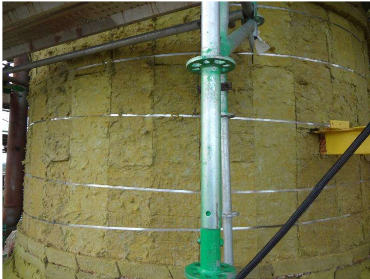
Imagem 2 - Isolamento em lã de rocha com fixação por cinta de aço inoxidável de 19 mm.
