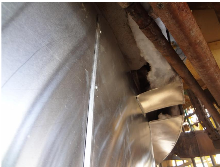
Imagem 5 - Região do costado e anel de vácuo onde houve recomposição com painéis de lã de rocha e chapas de alumínio liso conforme definição da inspeção.
