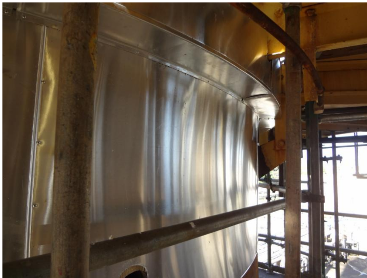
Imagem 4 - Região do costado onde houve recomposição com painéis de lã de rocha e chapas de alumínio liso conforme definição da inspeção.
