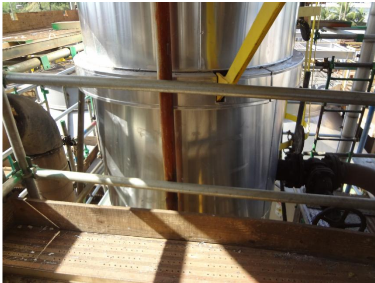
Imagem 7 - Região do costado e anel de vácuo onde houve recomposição com painéis de lã de rocha e chapas de alumínio liso conforme definição da inspeção.
