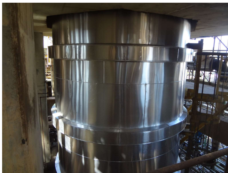
Imagem 2 - Região do costado e anéis de vácuo onde houve recomposição com painéis de lã de rocha e chapas de alumínio liso conforme definição da inspeção.
