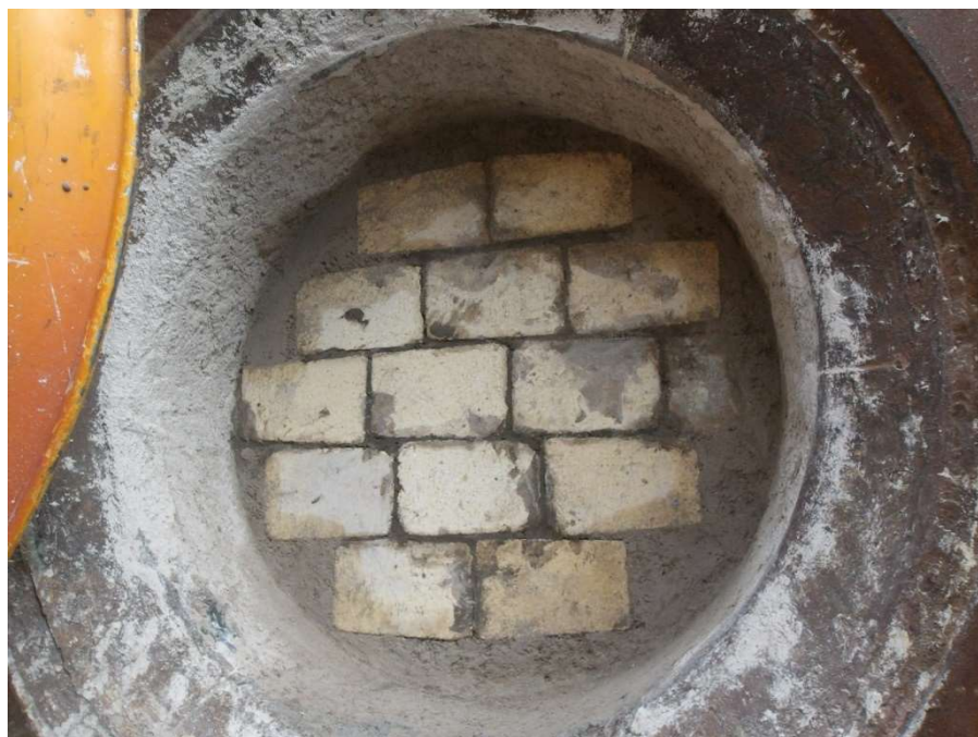
Figura 69 – Assentamento dos tijolos Alumibar 70 com argamassa refratária Placibar 68 U no fechamento da BV da chaminé.
