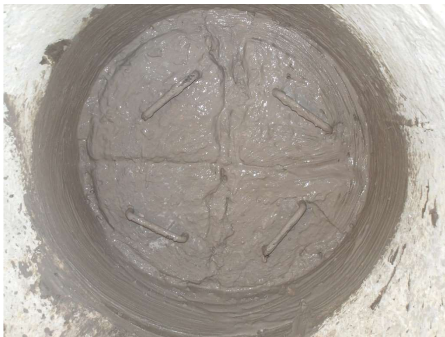
Figura 52 – Fechamento da BV com a reinstalação dos blocos e aplicação de argamassa refratária placibar 68U.
