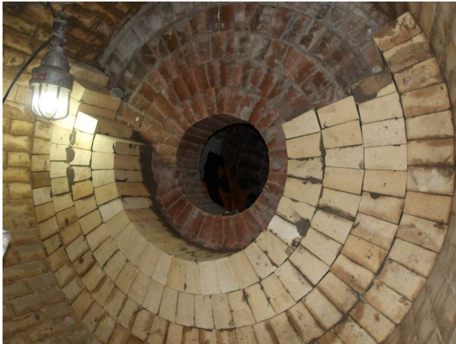
Figura 41 – Montagem da parede de contenção na redução com o duto de interligação com a chaminé.
