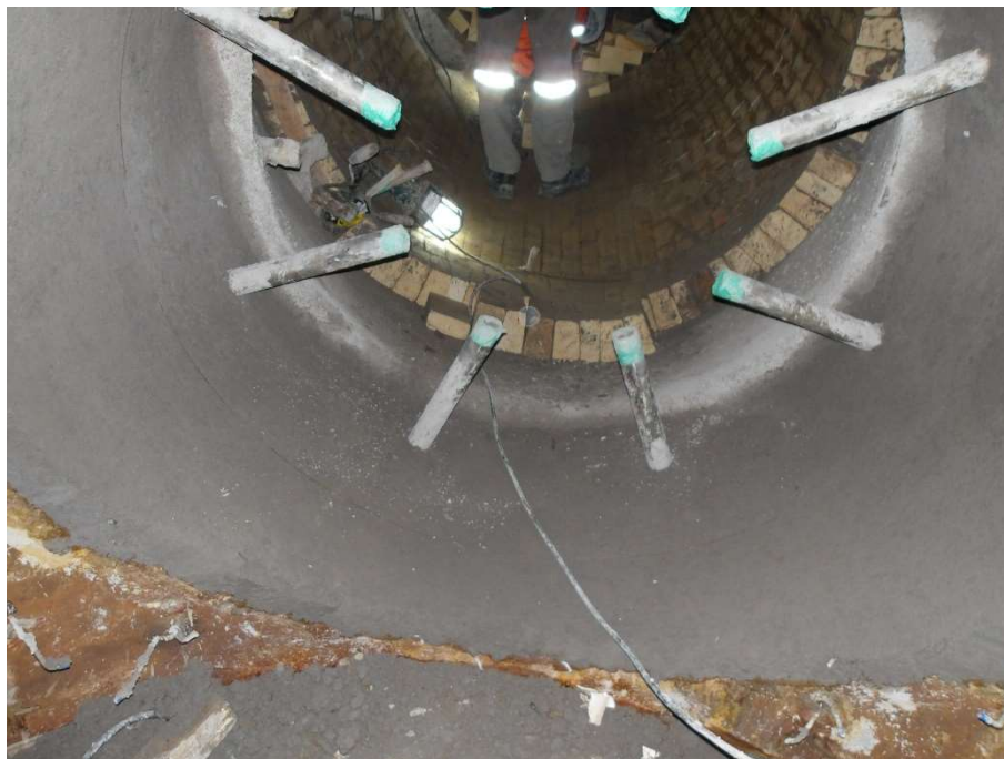
Figura 23 – Detalhe da conclusão da aplicação de PLW 41 no vaso incinerador na redução com o duto de interligação com a chaminé.
