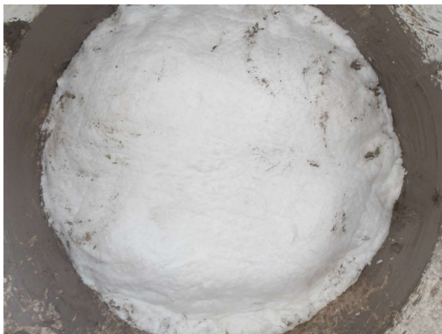
Figura 53 – Instalação da manta de fibra cerâmica de 128 kg/m 3 no fechamento da BV.
