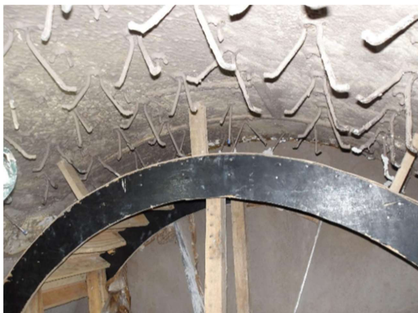
Figura 15 - Detalhe da utilização de cambota para socagem do concreto semi isolante na geratriz superior.
