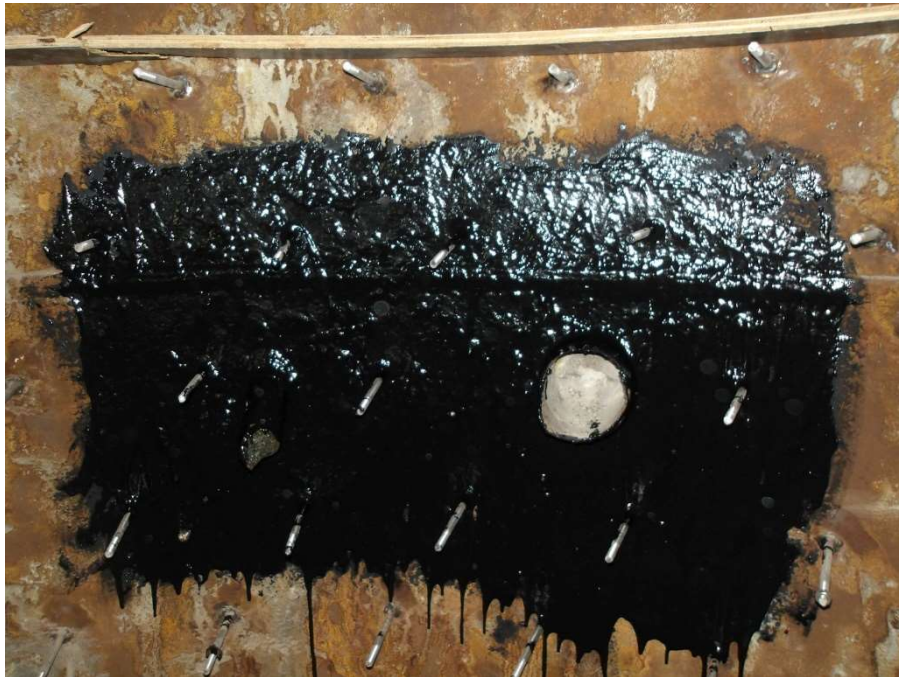
Figura 68 - Vista da aplicação da massa plástica anticorrosiva Kotibar AC feita nos bocais, conforme projeto.
