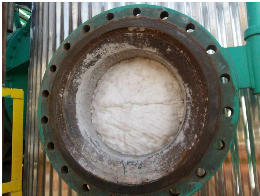
Figura 70 – Manta de fibra cerâmica de 128 kg/m 3 instalada após a camada de tijolos no fechamento da BV da chaminé.
