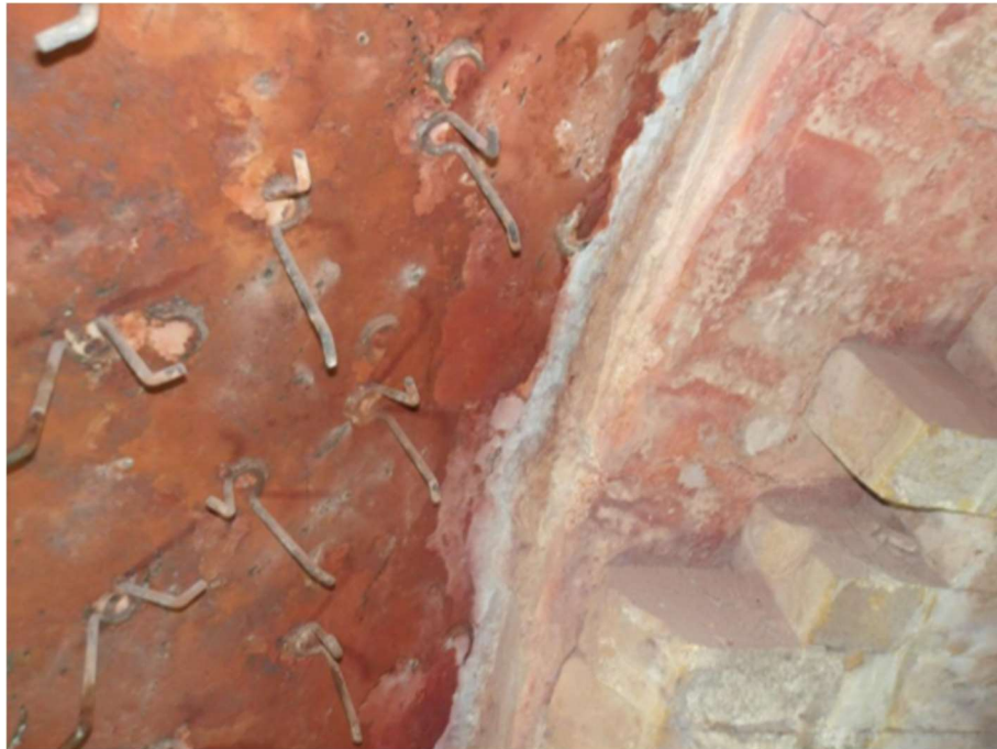
Figura 4 - Detalhe do costado durante a demolição do concreto e remoção dos tijolos do vaso incinerador.
