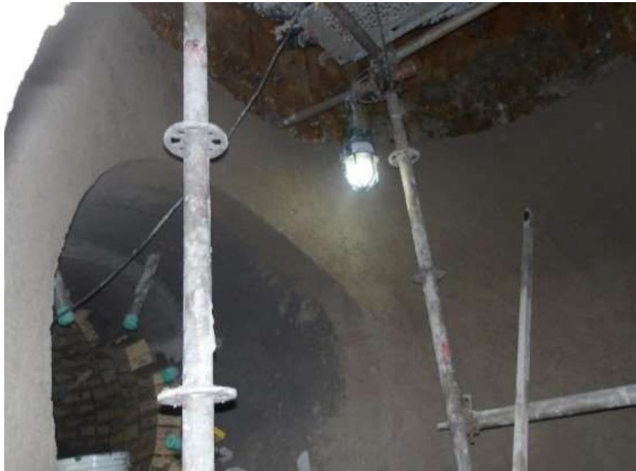
Figura 64 - Concretagem da chaminé com anti-erosivo na região da saída do duto de interligação com o vaso incinerador.
