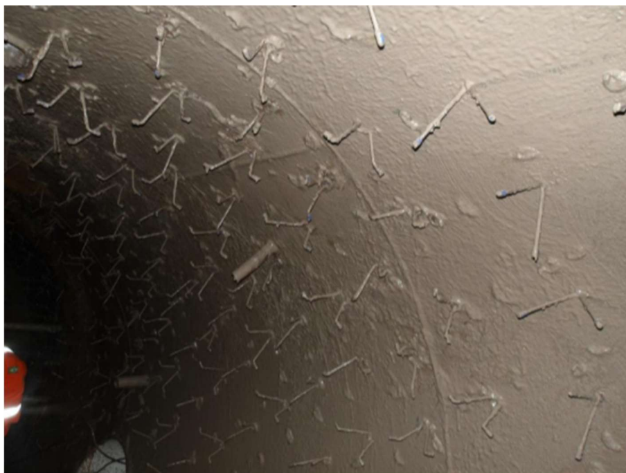
Figura 10 - Instalação das ancoragens com CAPS em suas extremidades e preparação da superfície do equipamento com Placibar SG para concretagem.
