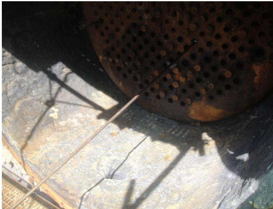
Imagem 2 - Carretel da GV-3601 atacado por enxofre
