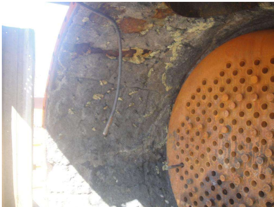
Imagem 6 - Carretel da GV-3601 atacado por enxofre
