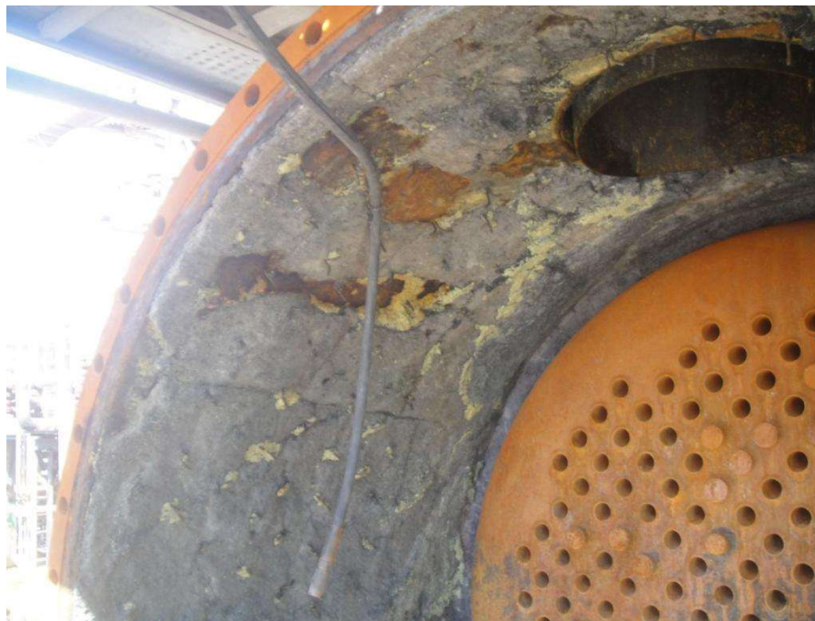
Imagem 3 - Carretel da GV-3601 atacado por enxofre
