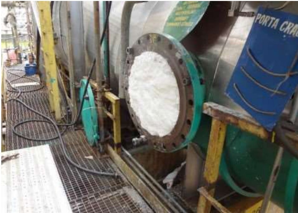
Imagem 31 - Fechamento da BV do B-3601 com tijolos e finalização com manta de fibra cerâmica
