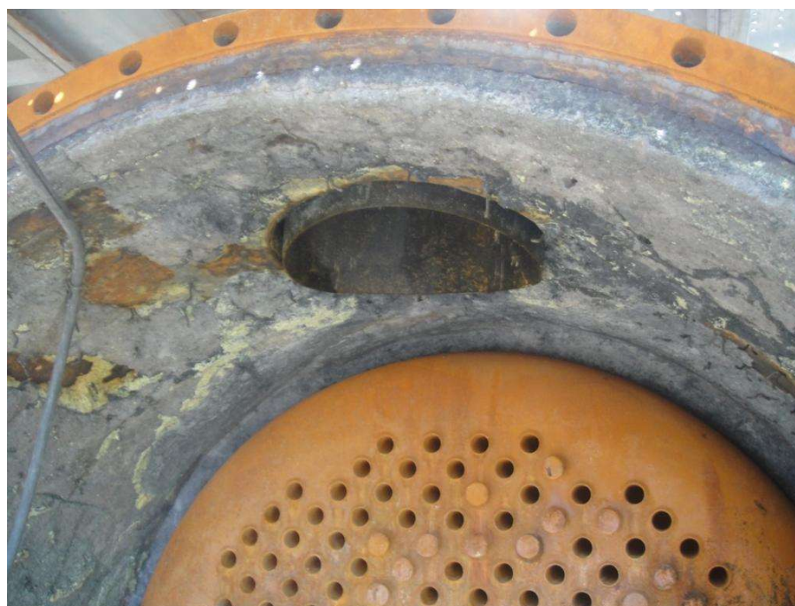
Imagem 4 - Carretel da GV-3601 atacado por enxofre
