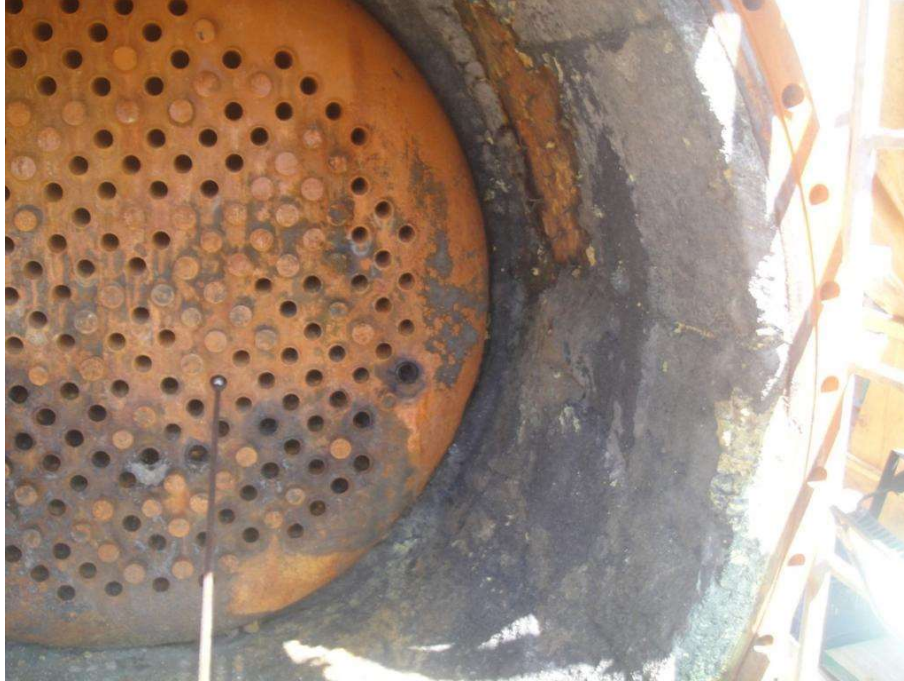
Imagem 5 - Carretel da GV-3601 atacado por enxofre
