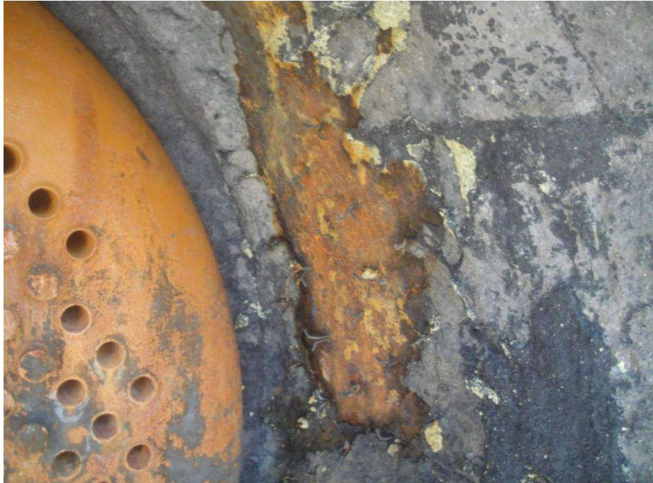
Imagem 1 - Carretel da GV-3601 atacado por enxofre
