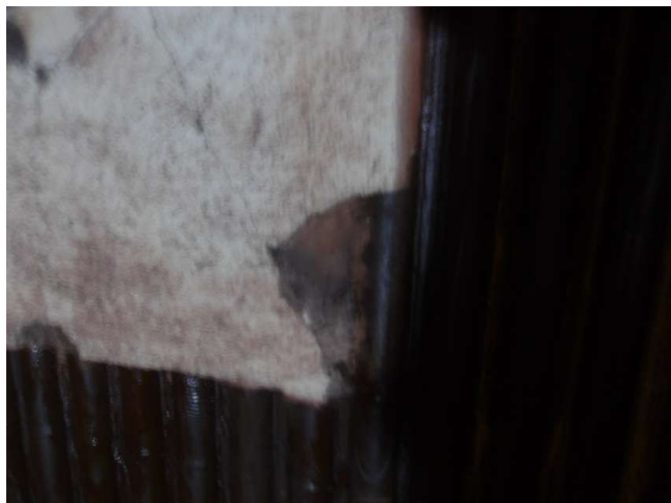
Foto 21 – Detalhe do defeito o refratário do queimador.
