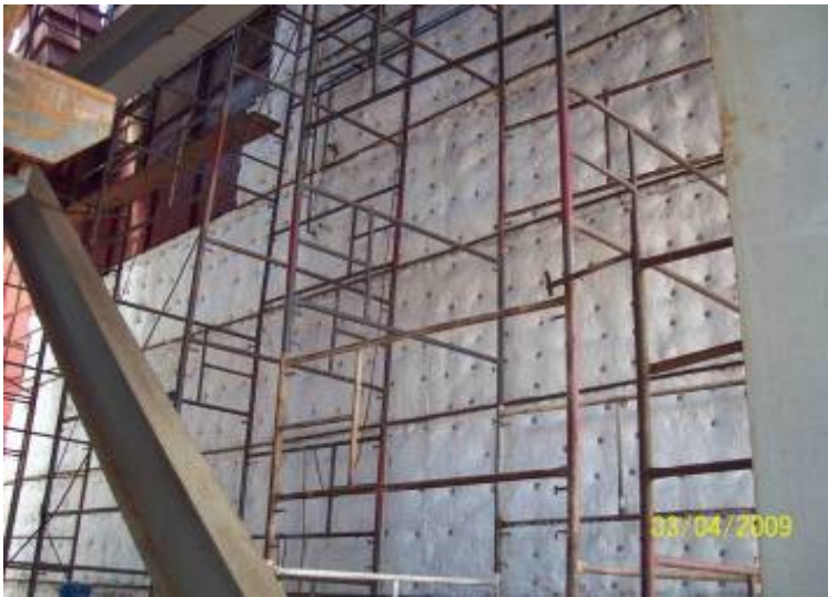
Parede de caldeira isolada com Thermofelt ®
