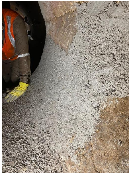
Imagem 2 - Aplicação de Castibar N para reparo do revestimento na entrada do equipamento
