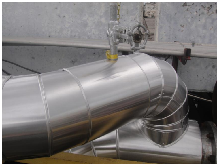
Imagem 3 - Jaqueta de proteção mecânica do isolamento com chapa de alumínio liso.
