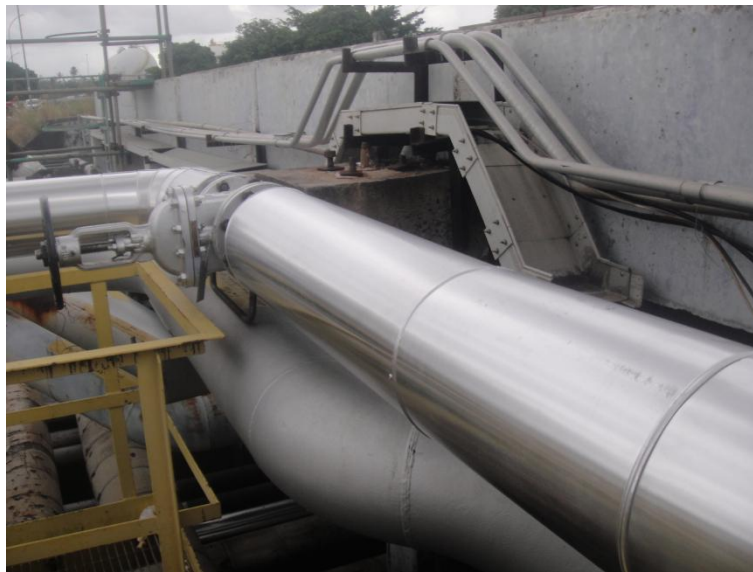
Imagem 5 - Jaqueta de proteção mecânica do isolamento com chapa de alumínio liso.
