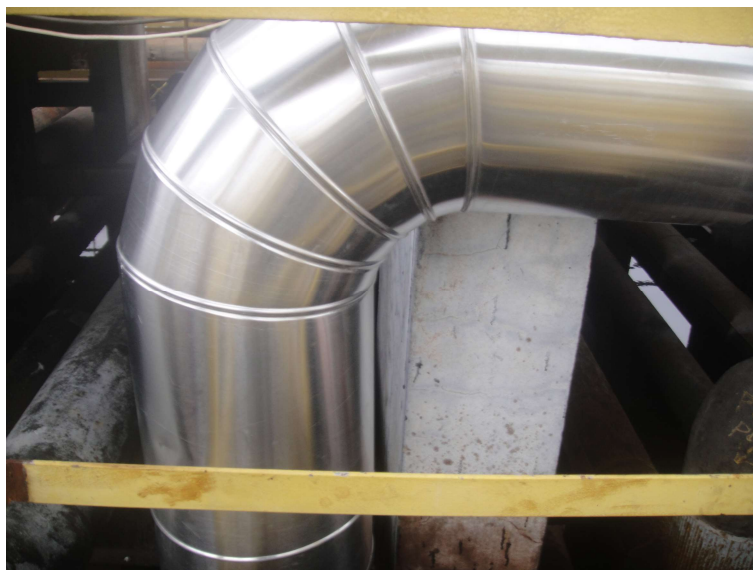
Imagem 4 - Jaqueta de proteção mecânica do isolamento com chapa de alumínio liso.
