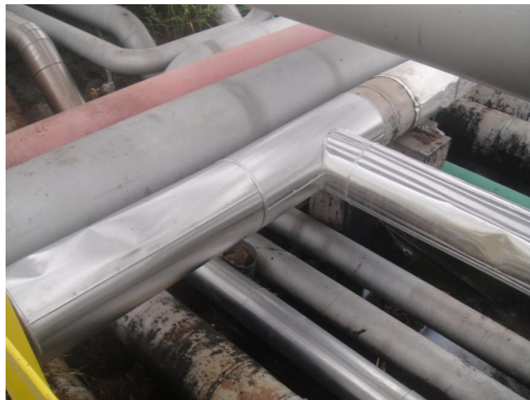
Imagem 8 - Jaqueta de proteção mecânica do isolamento com chapa de alumínio liso.
