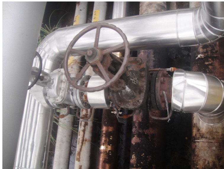
Imagem 7 - Jaqueta de proteção mecânica do isolamento com chapa de alumínio liso.
