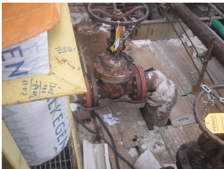
Imagem 1 - Exemplo de isolamento fibroso danificado a ser substituído nas linhas.
