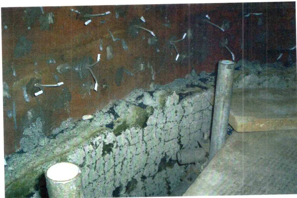
Região removida .Notar concreto velho.
