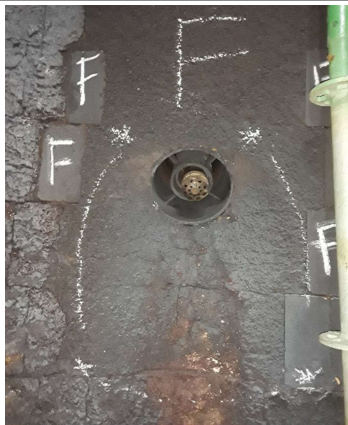
Bocal F antes da intervenção.
