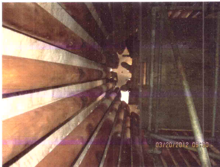
Foto 05 – Costado do H- 101 (foto interna)
