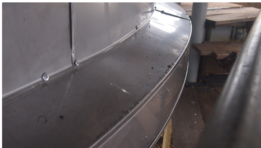
Figura 16 - Montagem do revestimento metálico fixado com parafuso inox e arruela de Neoprene nos anéis de vácuo.
