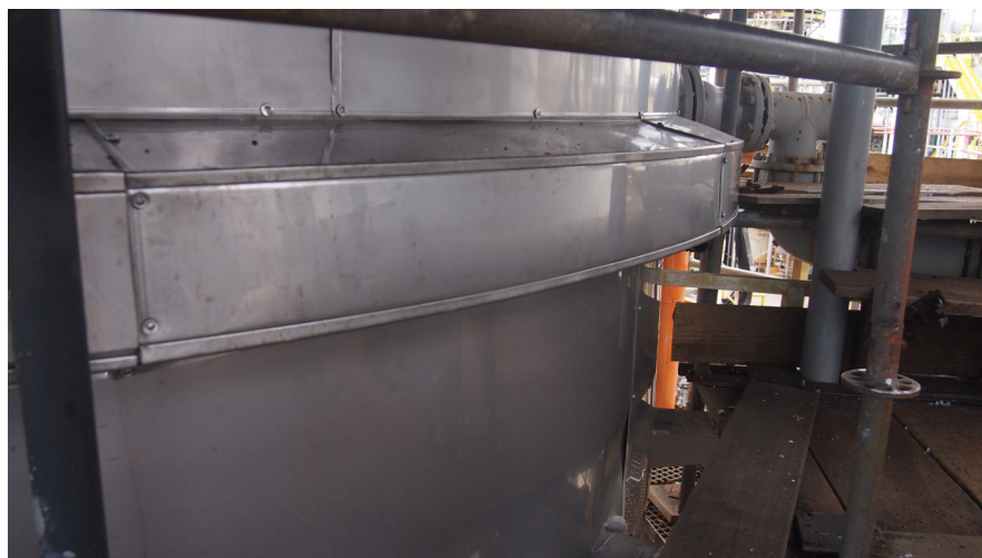
Figura 15 - Montagem do revestimento metálico fixado com parafuso inox e arruela de Neoprene nos anéis de vácuo.
