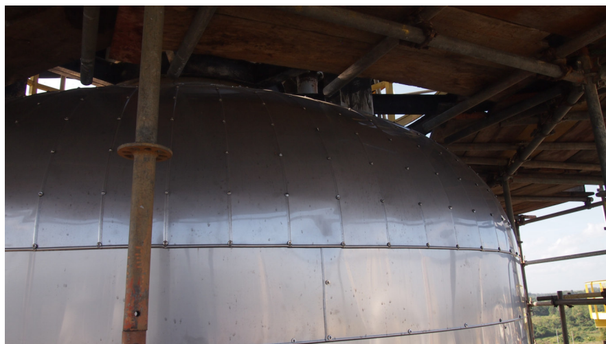
Figura 10 - Montagem do revestimento metálico fixado com parafuso inox e arruela de Neoprene.
