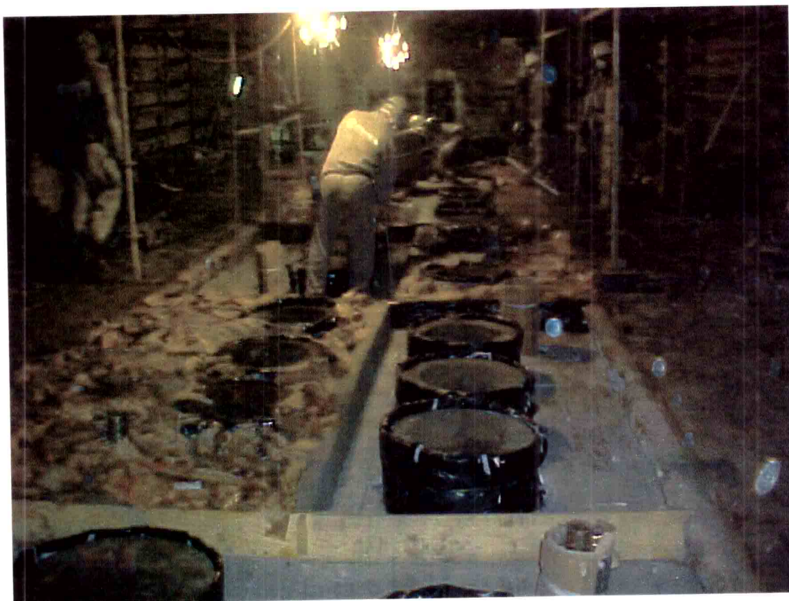
Forno B-3202.B: Concreto refratário isolante / Classe A / e = 200 mm
